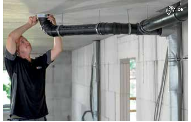
Şekil 39: Ses yalıtım hortumlu atık su borusu
