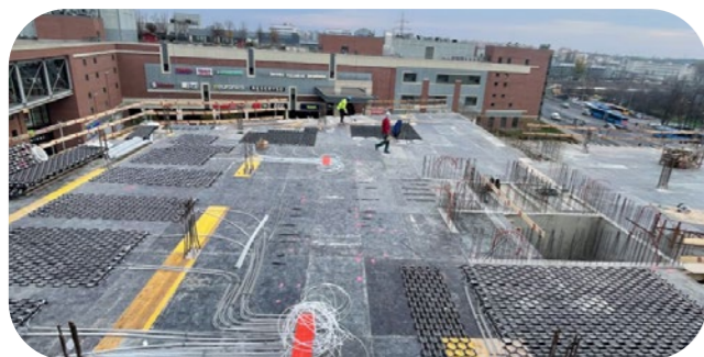
Betonové vývodky se spojovacími trubkami topného potrubí vedenými v ochranné trubce
