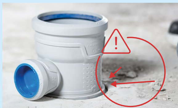
Obrázek 21: Stavební suť jako most pro přenos zvuku přenášeného tělesy
