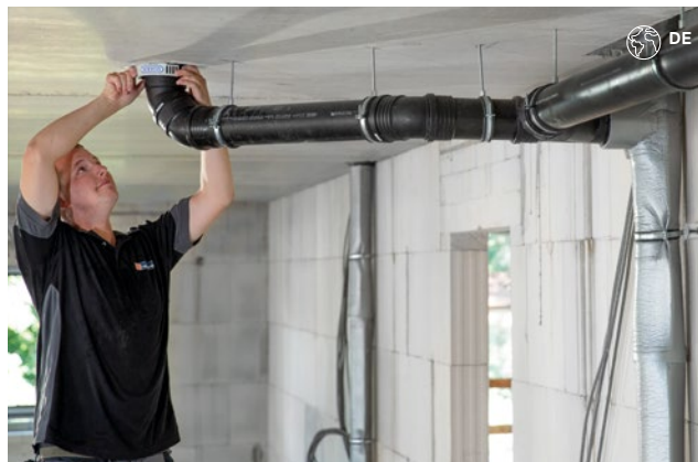
Obrázek 39: Odpadní potrubí s protihlukovým límcem
