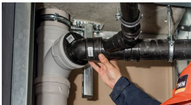
Obrázek 14: Příklad zakrytí potrubí
