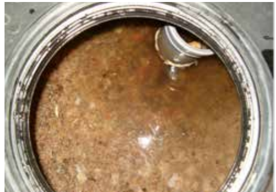
Şekil 2: Dolu yağ ayırıcıların üstten görünüşü
