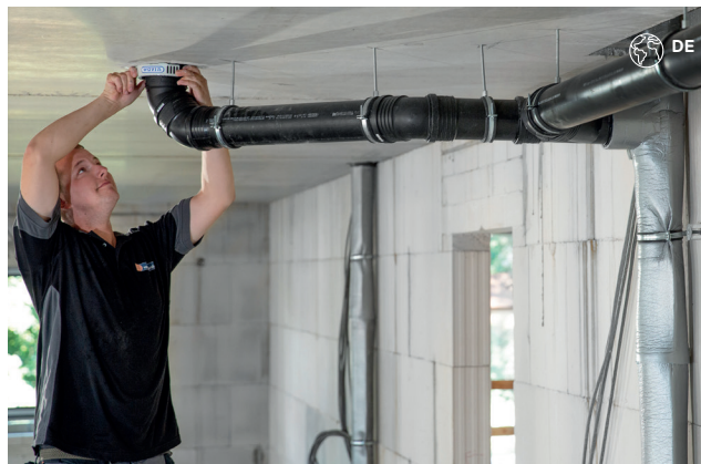
Figura 39: Tubazione per acque reflue con tubo fonoisolante
