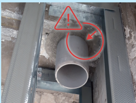
Figura 20: Mancato disaccoppiamento acustico strutturale
