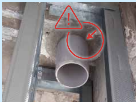
Rysunek 20: Brak izolacji rury od kontaktu z konstrukcją budynku
