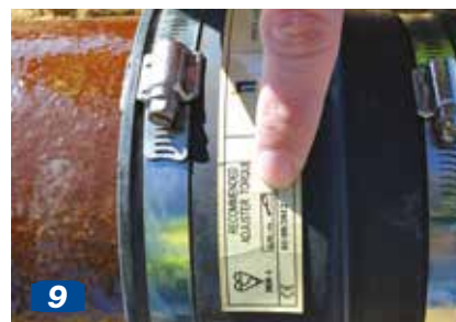
9 På mærkaten på overgangen står der anført hvor mange N-m, der skal spændes med.
