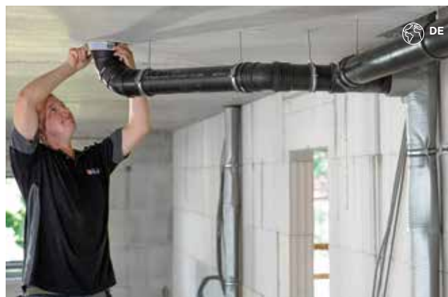
Bild 39: Avloppsrör med ljudisolerings slang
