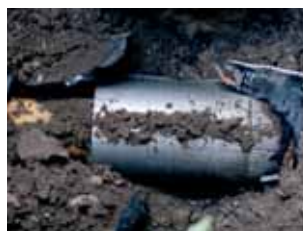
Рис. 65. Разрушение трубы с заменой при помощи труб Wavin TS в Познани, Польша
