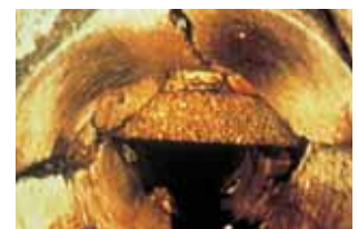
Рис. 6. Сильно поврежденная канализационная труба
