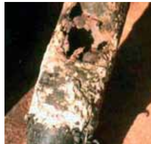
Рис. 3. Труба газопровода, сильно поврежденная коррозией
