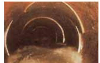
Рис. 4. Структурные повреждения и отложения в канализационной трубе
