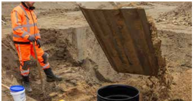
8. Fyll med omfyllingsmasser rundt kummen i henhold til "Legging av plastrør for vann og avløp", NPG. Plasser en treplate på kummen eller monter stigerøret, for å hindre at omfyllingsmasser faller ned i kummen under tilbakefylling. Komprimeringen bør samsvare med eksisterende jord- og vannforhold og fremtidig ytre belastning.
