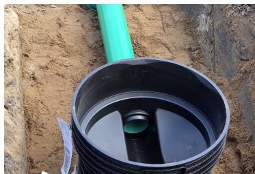
Eingebauter Tegra 600 LC mit Zulaufleitung.
