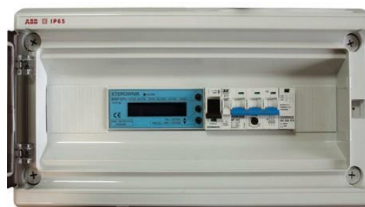
Rysunek 2. Szafka zasilająco-sterownicza przepompowni z zasilaniem 1-fazowym
